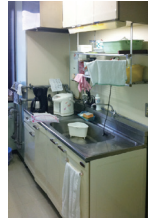
壁掛け型ガス湯沸器
